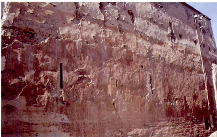
Fig. 19.- Vista de la fachada de una casa tradicional de la madīna de Marraqués. La superficie lisa de la obra de tapial de tierra sólo se ve interrumpida por las angostas aberturas de las ventanas que, a modo de aspilleras, facilitan la iluminación y ventilación de las habitaciones. Esta fachada es fiel reflejo del carácter introvertido de la vivienda islámica, que cerrada a la calle se abre sólo a su patio interior.
