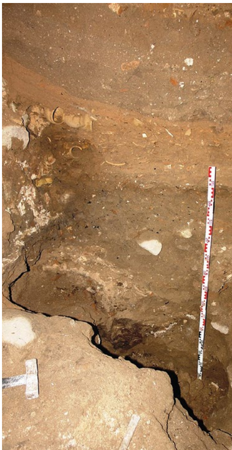
Fig. 3. Zona de colapso y hundimiento de la bóveda de la canalización.
