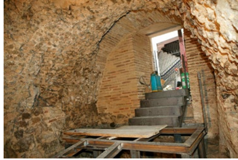
Figura 10. Vista de la bóveda de la cisterna-2 y acceso desde el patio.
