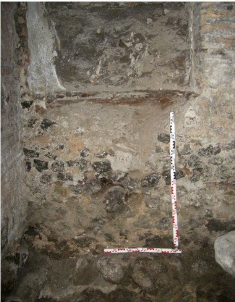
Figura 12. Vista del cierre sur de la cisterna-2 y unión de los dos muros.
