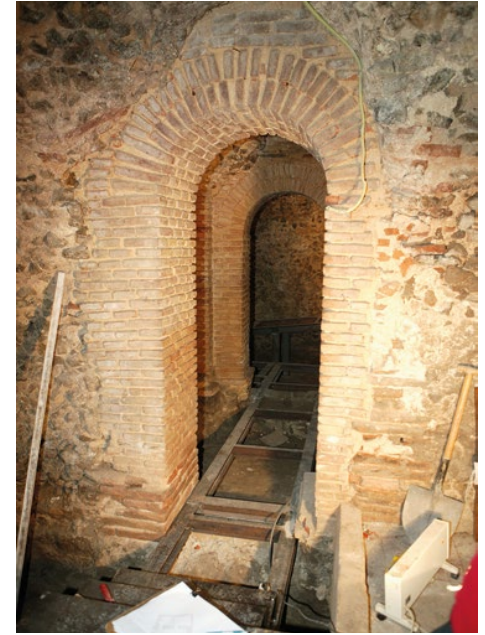
Figura 11. Vista vanos de acceso a las cisternas desde el interior de la cisterna-2.
